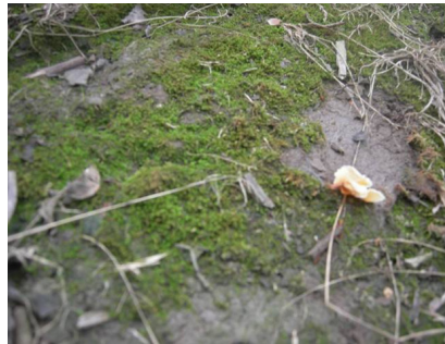
Figura 4.4. Sellamiento superficial y erosión del camellón.
