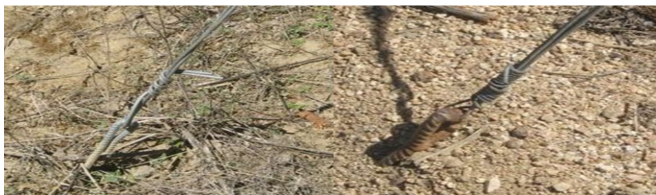
Figura 8.9. Condición de anclas. A: Ancla en buen estado (izq.). B: Ancla Oxidada (der.)
